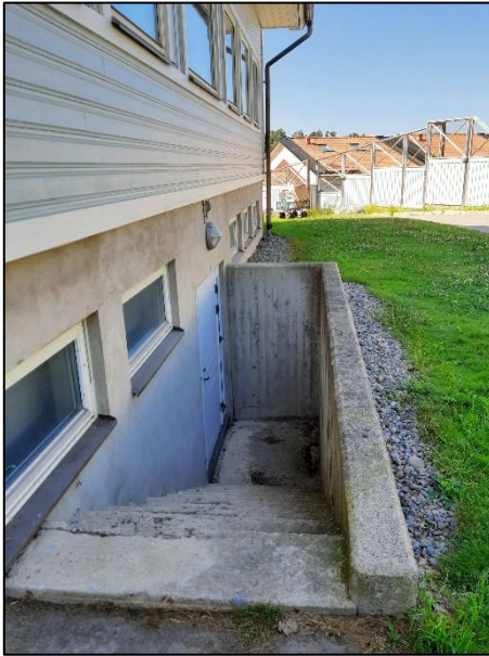
Figur 13 Utsatt källarnedgång vid kraftig regn
